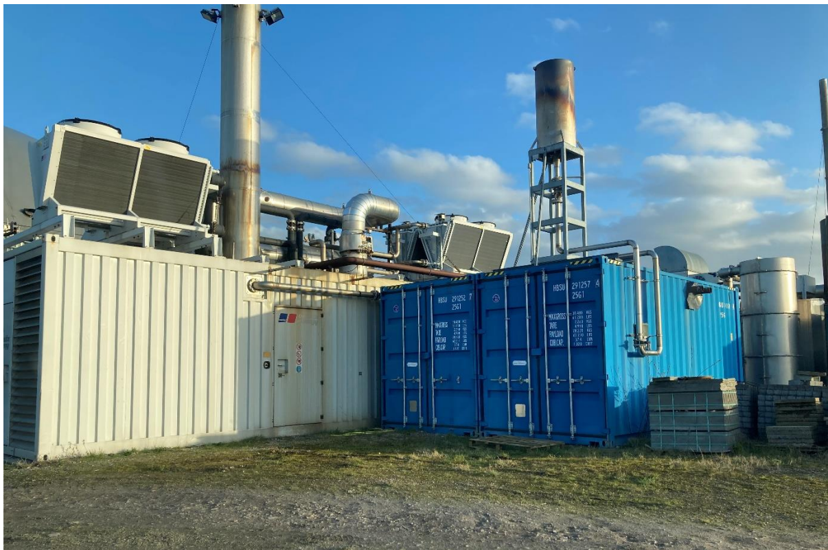
Abbildung 9: Heizcontainer und Schornstein im südwestlichen Plangebiet, Elberg 2023.
