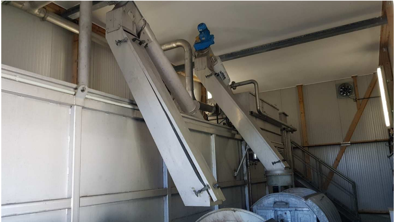
Abbildung A2.2 Halle mit Rechengut und Sandfang.
