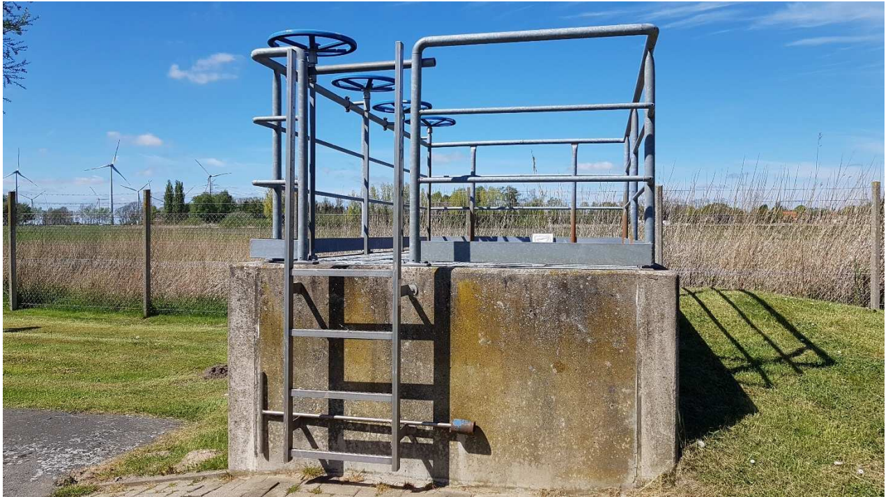
Abbildung A2.3 Pumpwerk zwischen Schlammstapel und Belebung.
