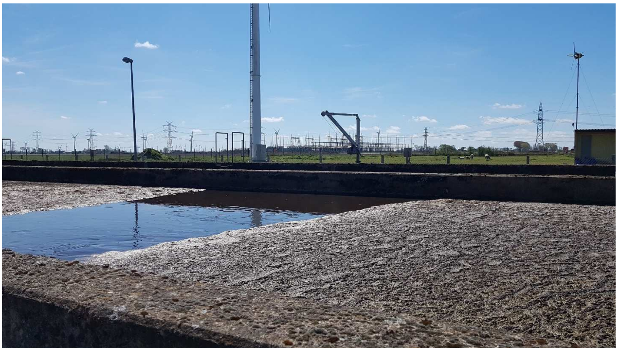
Abbildung A2.5 Vorderer, unbelüfteter Teil der Belebung.
