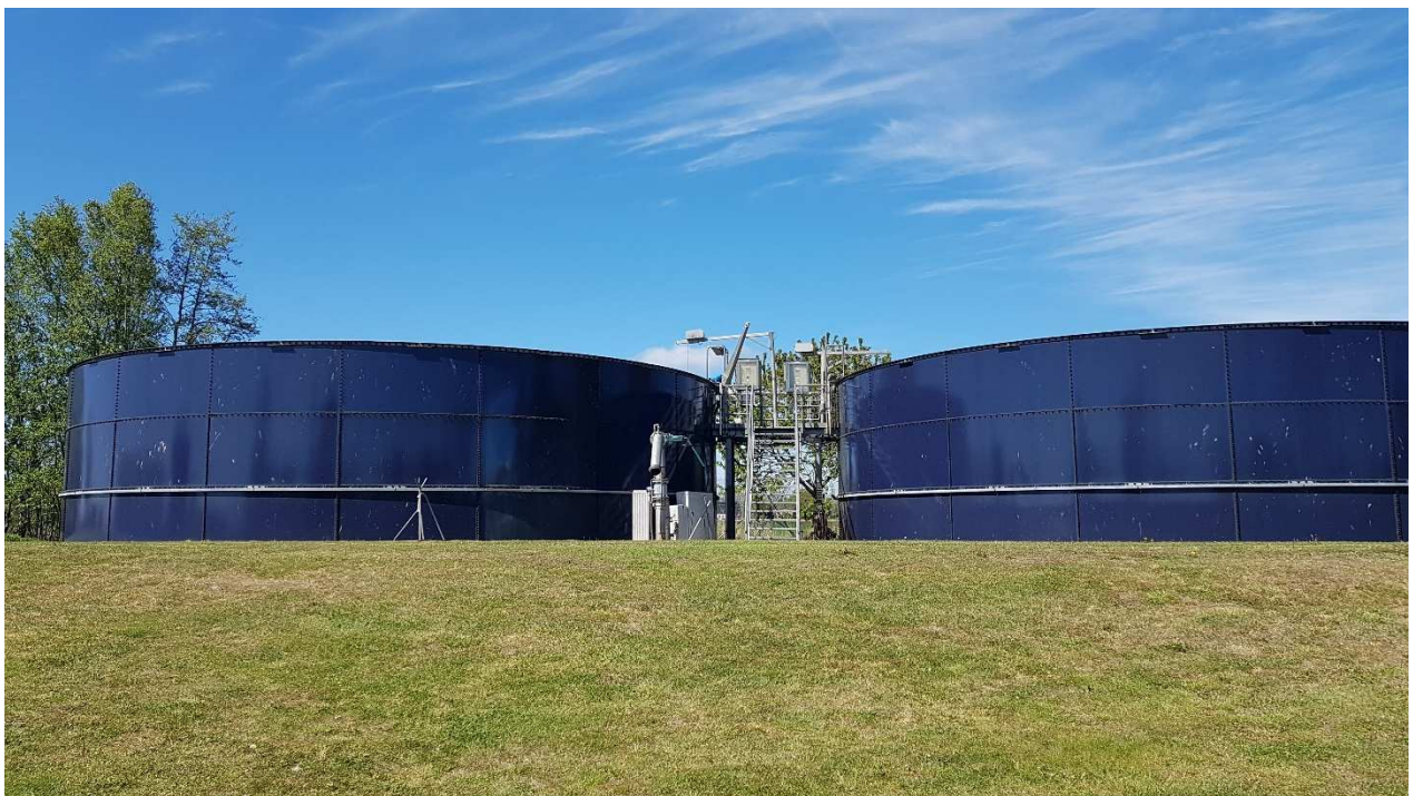
Abbildung A2.2 Schlammstapelbehälter mit 1000 m 3 Fassungsvermögen.
