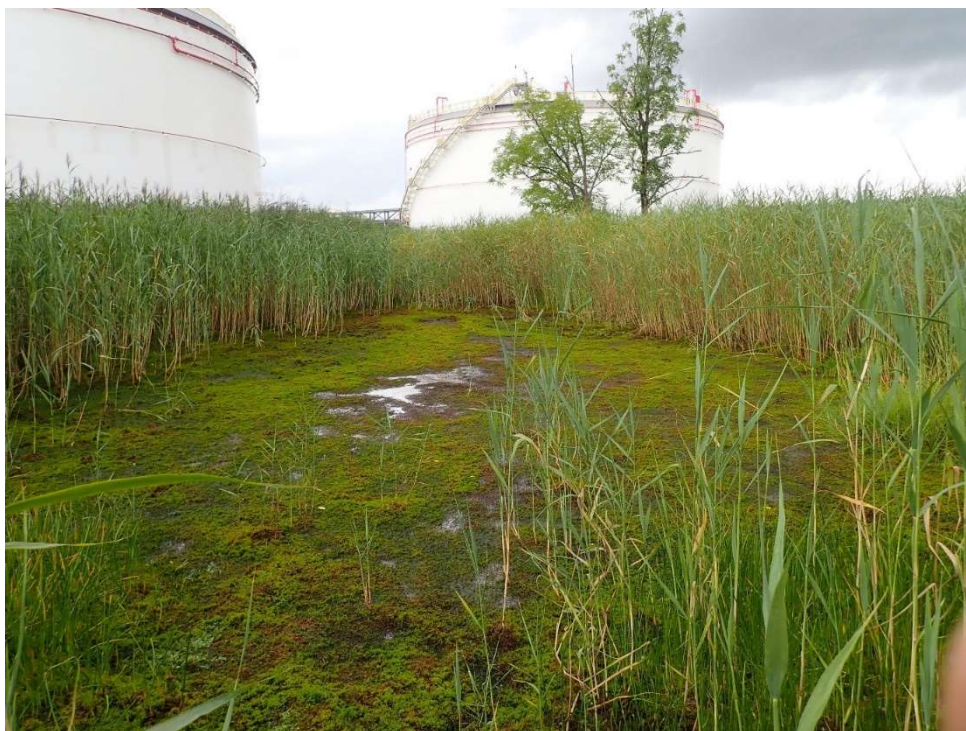
Abbildung 5: Wasserfläche im Tankfundament (FXy)
