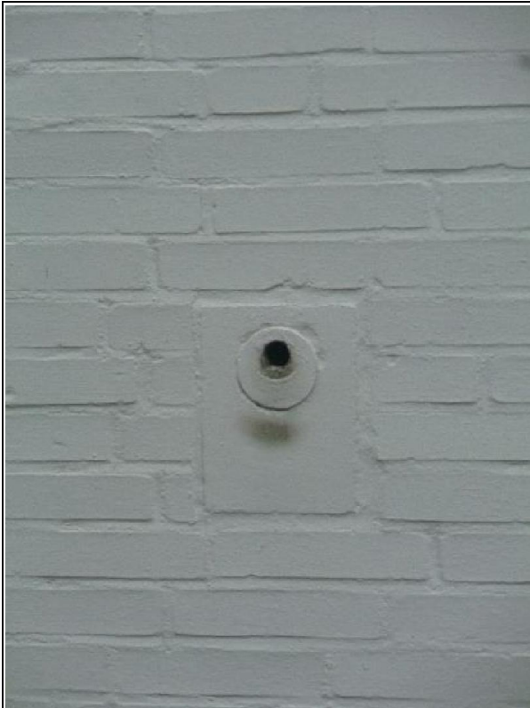
Abbildung 6: „Einflugloch“ in der Gebäudefassade mit deutlichen Abriebspuren vermutlich durch den Anflug zahlreicher Fledermauskörper ans Loch
