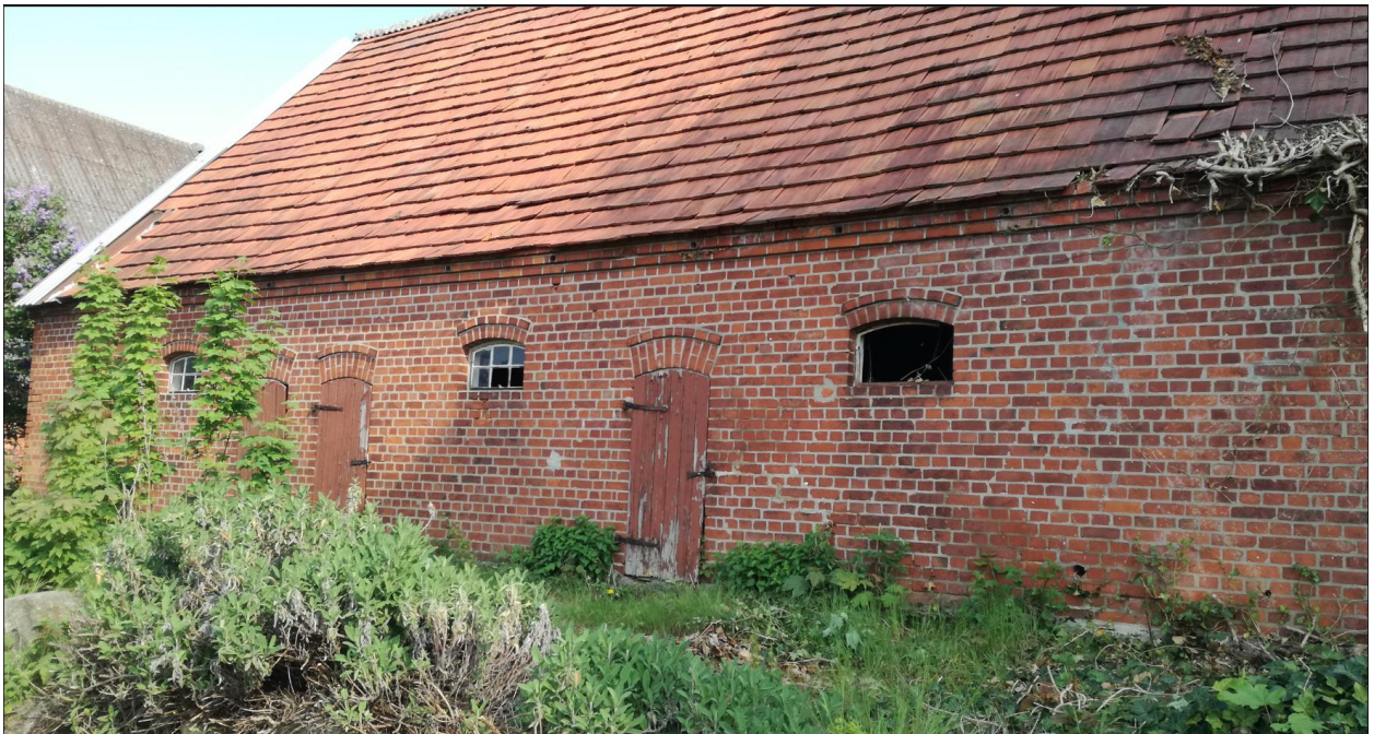
Ehemaliger Schweinestall, Fenster fehlen z.T., Dach weitgehend intakt
