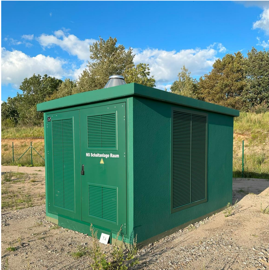
Abb. 8: Beispiel einer Trafo-Station (Quelle: EE-Plan GmbH)
