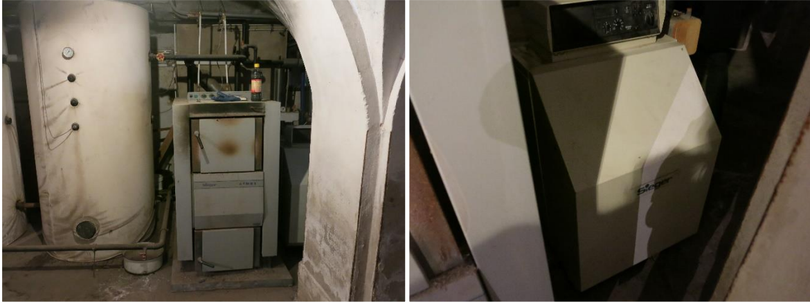
Abbildung 2: Aufnahme eines Pufferspeichers, Gas- sowie Ölkessels im Keller des Schlosses
