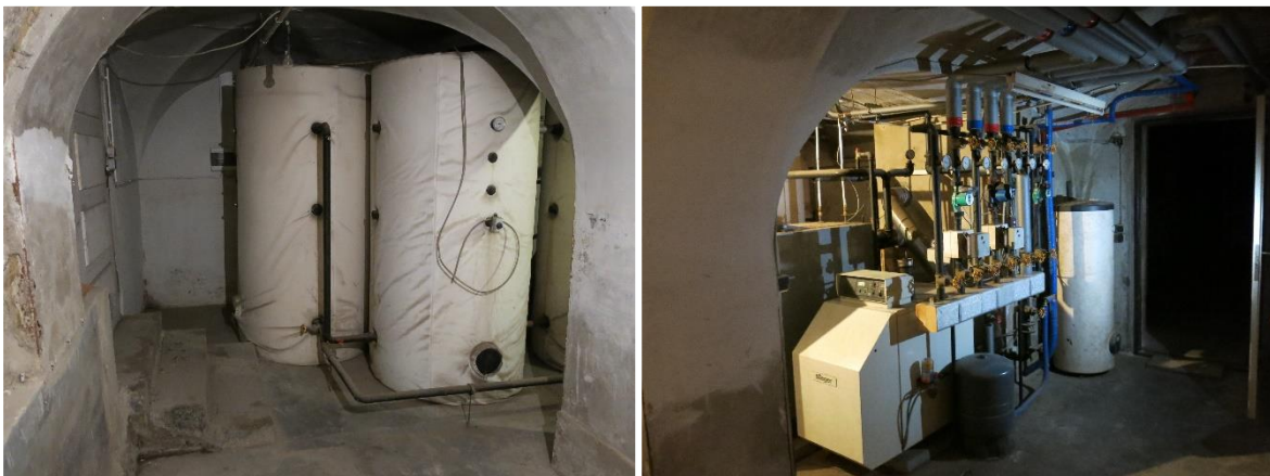
Abbildung 3: Aufnahme der Pufferspeicher, des Trinkwasserspeichers und Heizkreisverteiler im Keller des Schlosses
