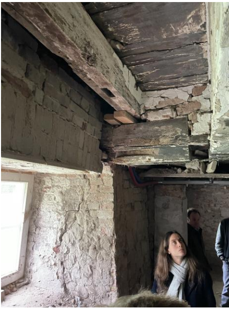
Beispiel Fenstersturz Souterrain stark verform
