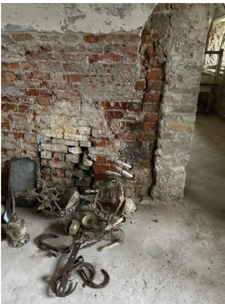
Beispiel abgängige Wand Souterrain Raum SCHL_0_02_03 - UG
