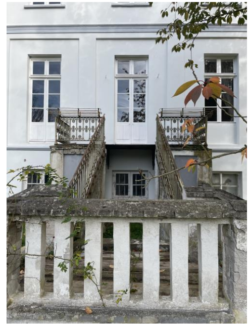
fehlende Stufen Freitreppe Südseite
