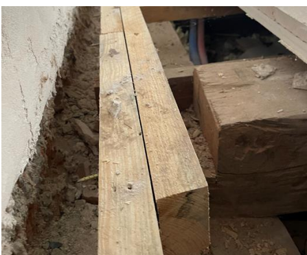
Ausgeklinkter Balkenkopf für nicht fachmännisch verlegte Heizleitungen -> Balken statisch stark geschwächt - Südflügel OG
