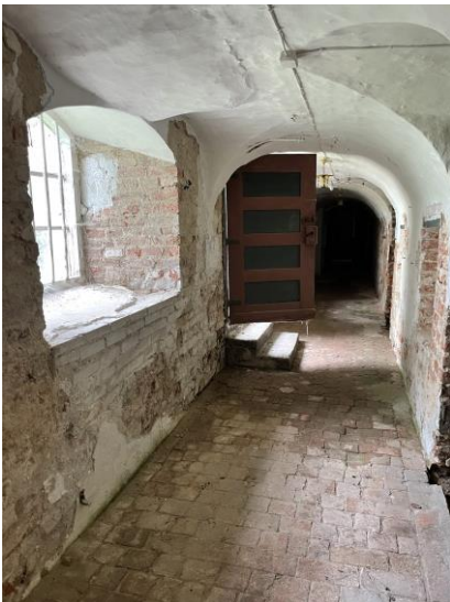
Feuchteschaden Nordflügel Innenhof
