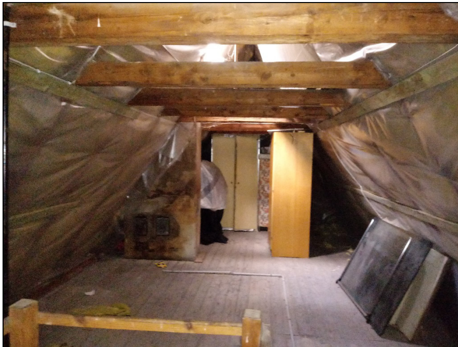
Abbildung 2: Dachboden Haus Nr. 10 (Nr. 6 und 8 baugleich), Dach mit Mineralwolle gedämmt, Schutzfolie z. T. mit Löchern
