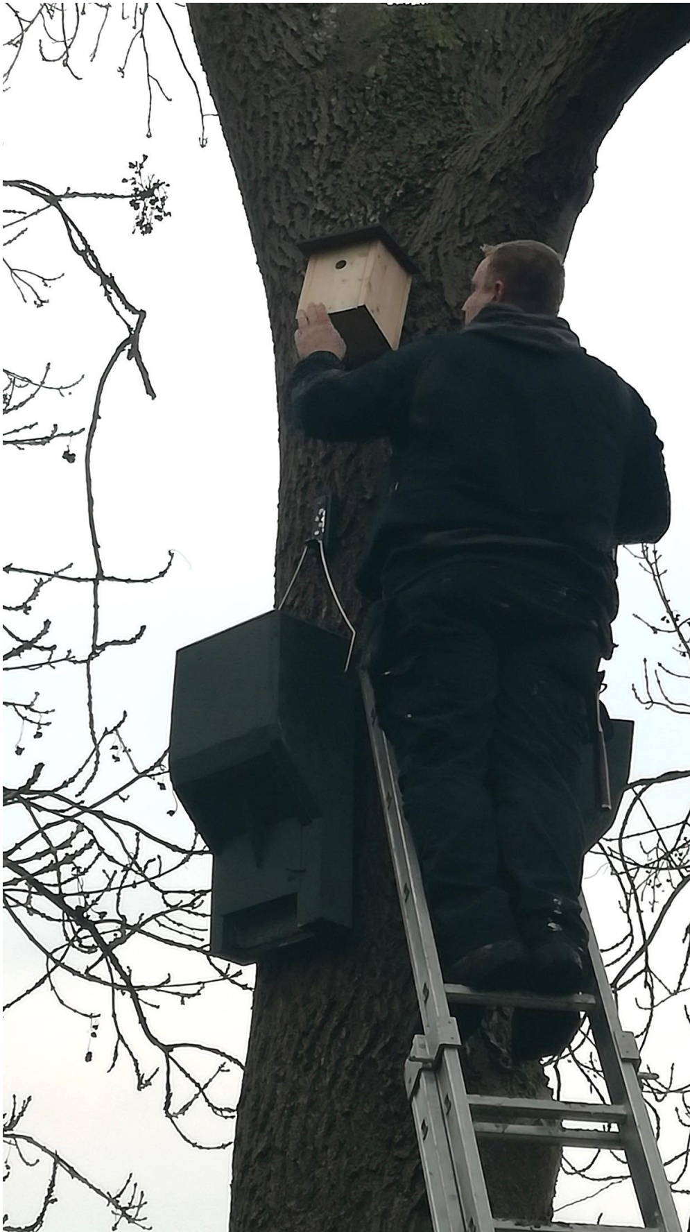
Anbringung Winterquartier Fledermäuse, Wochenstube und Meisenkasten
