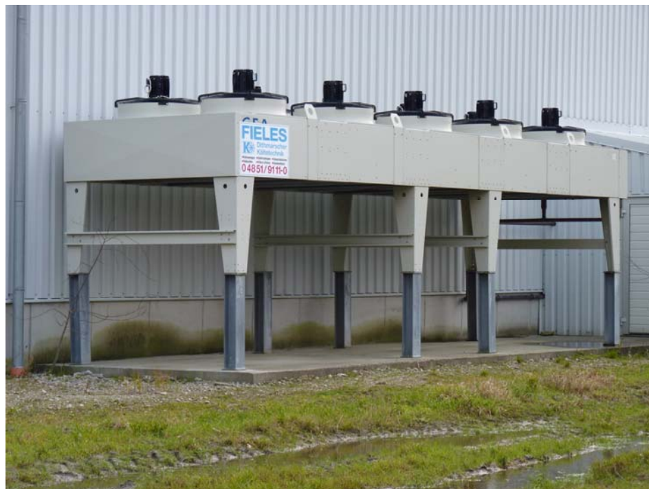
Abbildung 1: Axialverflüssiger an der Westwand der Möhrenhalle
