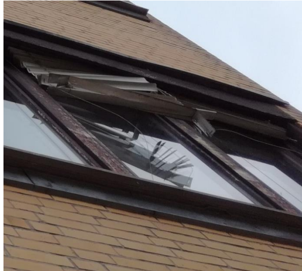
Abb. 6: Defekte Jalousien an der Westseite des Gebäudekomplexes
