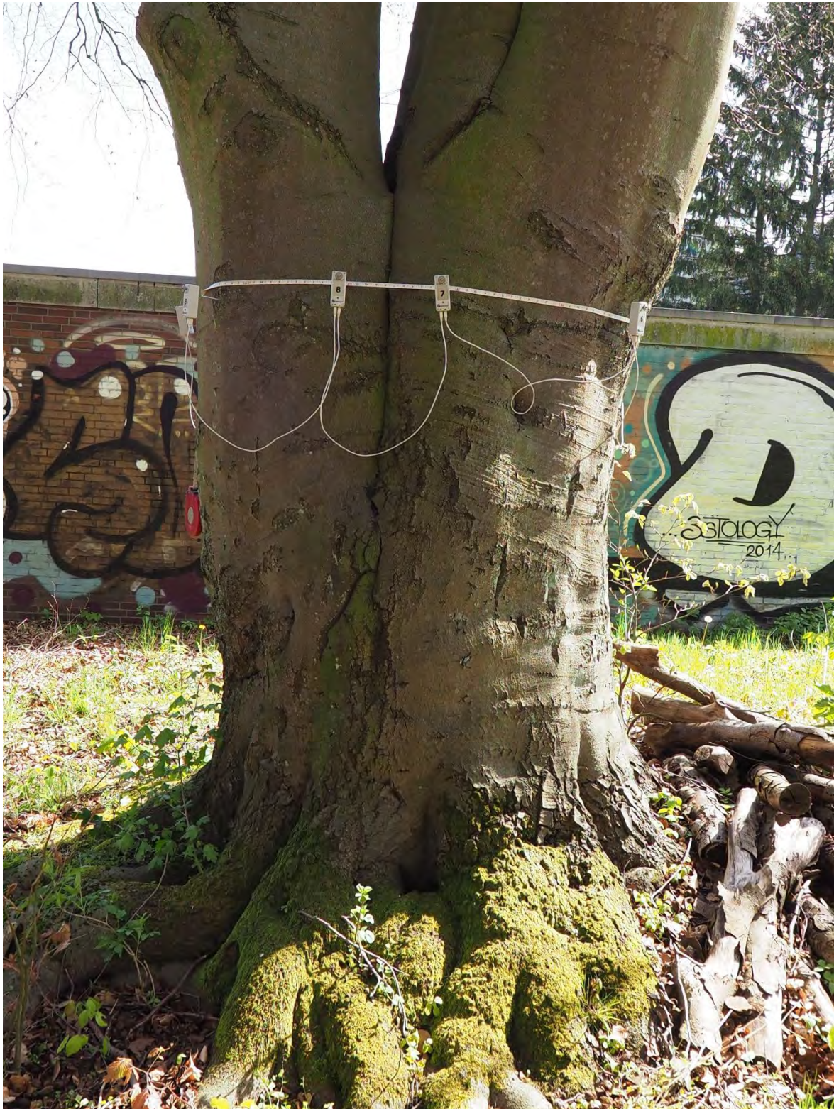
Abb. 2: Blick auf die im Gutachten erwähnte Rissbildung unterhalb der Gabelung der beiden gleichstarken Stämmlinge. Messpunkte unterhalb der Gabelung.
