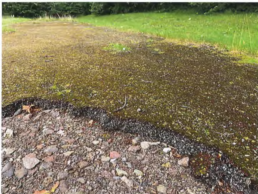
Foto 6 Blick auf die teilweise aufgerissene Tartanbahn. Darunter ist eine Schottertragschicht zu erkennen.
