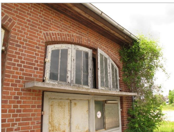
Foto 5: Ostseite von Gebäude Nr. 2 mit Fassadenbegrünung und offenen Fenstern, was die Zugänglichkeit durch Tiere vereinfacht.
